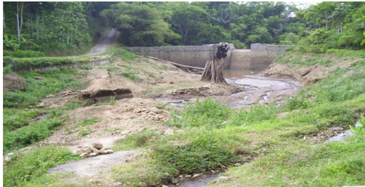
Foto 1. Pemanfaatan Dam yang tidak optimal bagi pertanian, Survey Lapangan, 2006
